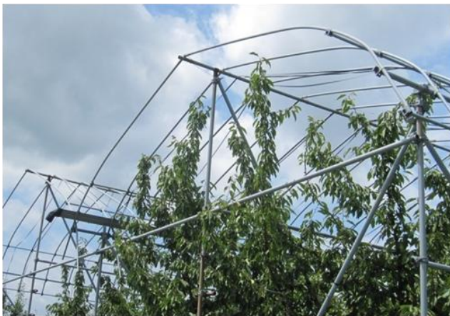
妻面の屋根が張り出していると、 被覆やパッカー止め作業が危険
