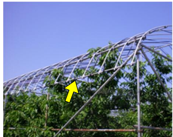
アーチパイプ先端の 横パイプには乗らない
