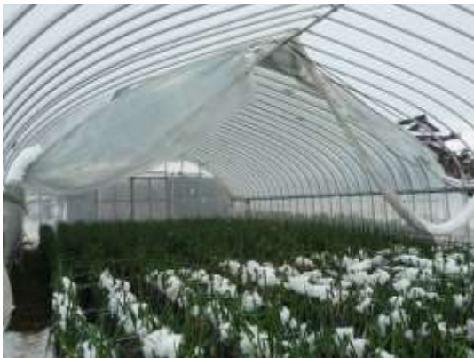
写真20 被覆資材が破損し、作物 が雪を被った状況
