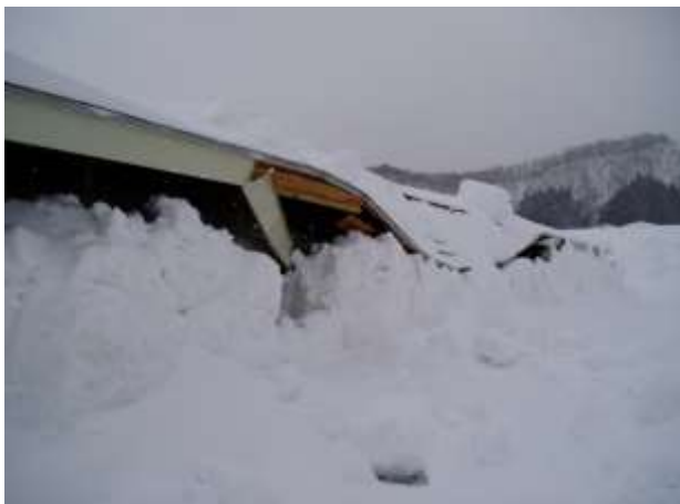
写真14 畜舎軒先の損壊状況
