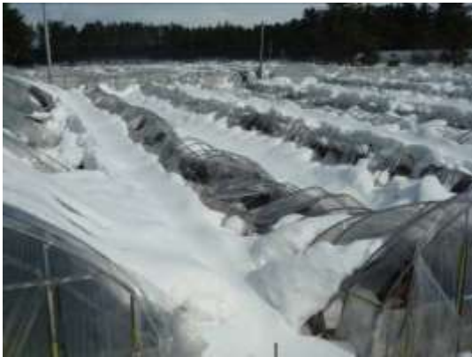
写真18 倒壊したハウスの状況 (外側)
