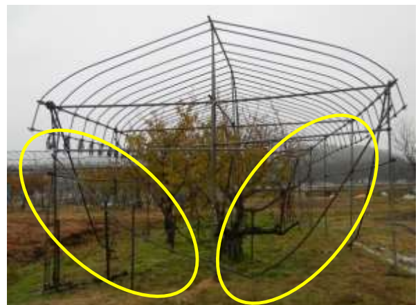
写真7 沈降力により変形した筋交いパイプ
