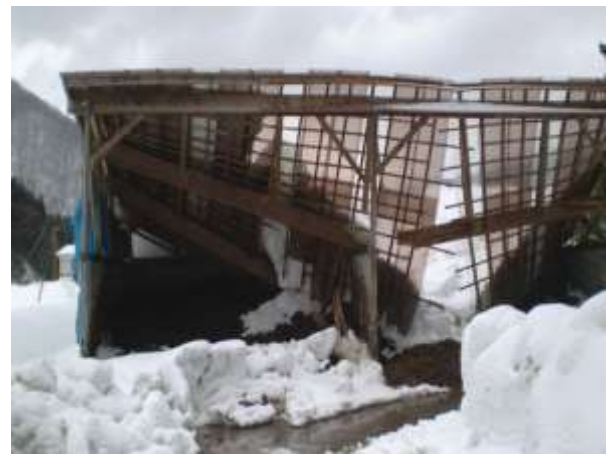
写真15 堆肥舎屋根の損壊状況
