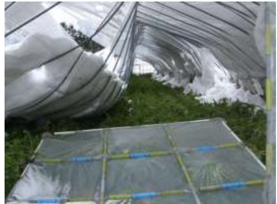
写真19 倒壊したハウスの状況 (内側)
